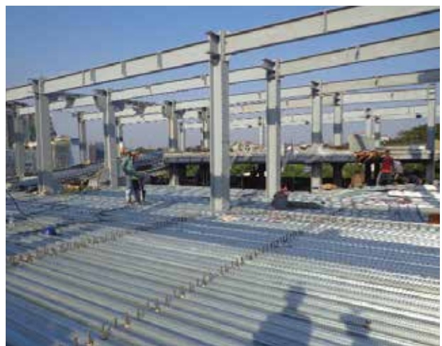
DẤM THÉP LIÊN HỢP VỚI SÀN BÊ TÔNG, TẤM SÀN VÀ ĐINH NEO
