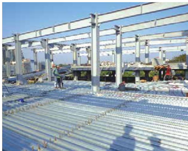
DẮM THÉP LIÊN HỢP VỚI SÀN BÊ TÔNG, TẤM SÀN VÀ ĐÌNH NEO
